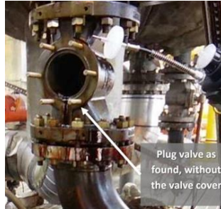
รูปที่ 3 วาล์วหลังเกิดเหตุ
