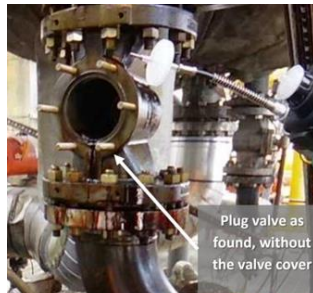
Figur 3. Ventilen efter uheldet
