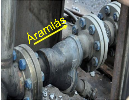
1. ábra: hegesztett saválló vezetékbe nem megfelelően beépített öntöttvas Y-szűrő
