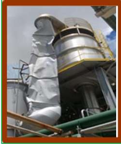
Figura 1: Conducto de entrada a secador, colapsado por vacío.
