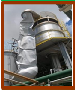
Figura 1: O coletor de entrada no secador colapsou sob vácuo
