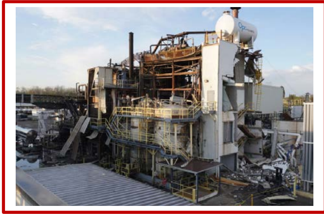
Rajah 1. Bangunan resin selepas letupan dalam (Sumber: CSB laporan No. 2021-04-I-OH)
