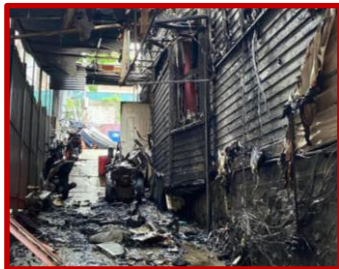
Figura 1: Danos em prédios causados por um incêndio numa bateria de íons de lítio.
