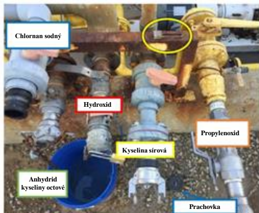
Obrázek 1: Připojovací místa k nádržím v MGPI. Visací zámek na potrubí pro kyselinu sírovou (zakroužkováno) položený na kovovém rámu. Protiprachový uzávěr z potrubí chlornanu sodného na zemi. (Zdroj: zpráva CSB 2017-01-I-KS)
