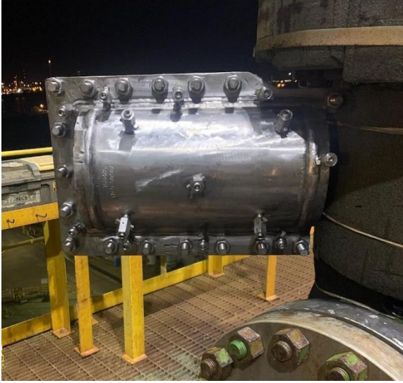
Şekil 1. Sızdıran bir vana üzerindeki geçici bir Boru kelepçesi
