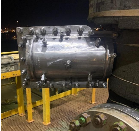
Figura 1. Un collare di riparazione temporaneo installato su una valvola che perdeva
