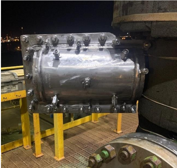
Abbildung 1. Eine provisorische Rohrreparaturschelle über einem undichten Ventil
