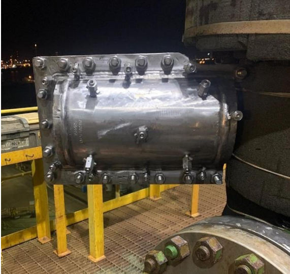
Figure 1. Un collier de réparation de tuyau temporaire par-dessus une vanne qui fuyait
