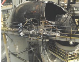
Fig. 2: Después del incendio
