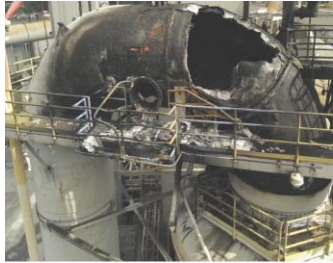
شکل ۲: بعد از حریق
