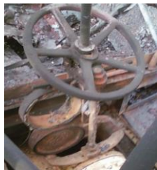
Figura 3 Tubería con disco ciego tras accidente
