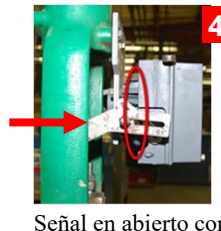
Señal en abierto con enlace dañado
