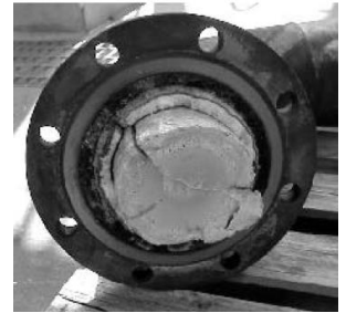
Fig. 1 Conducta de aerisire colmatata
