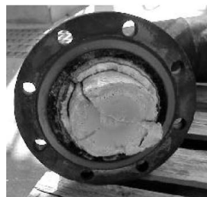
图1 被堵塞的排气管
