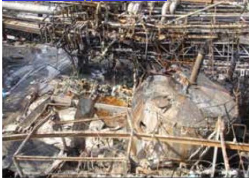
Photo 1 : Réservoir d'AA détruit
