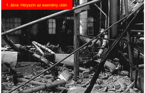
2. ábra: Tönkrement vezeték
