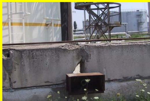
Tháng 6 – một lỗ trên tường bê tông bảo vệ chống tràn kết chứa
