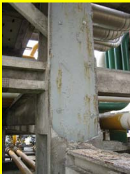
Tháng 5 – hư hỏng sơn chống cháy trên cột đỡ đường ống
