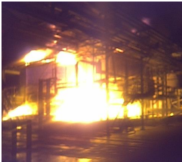
Εικόνα 1. Δεξαμενές τυλιγμένες στις φλόγες μετά από κεραυνό
