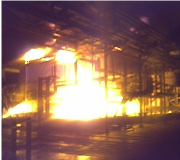
Abbildung 1. Nach einem Blitzeinschlag... brennende Tanks
