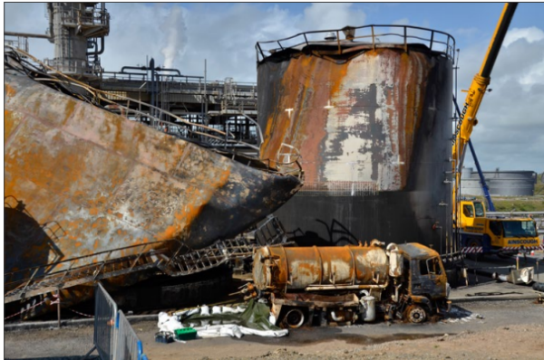
Bild 1. Fabriken efter explosionen och branden
