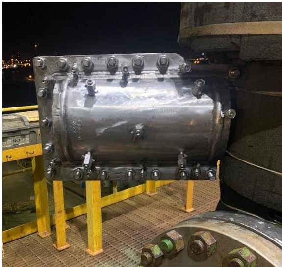
Figura 1. Grampo temporário de tubagem sobre uma válvula que tinha uma fuga
