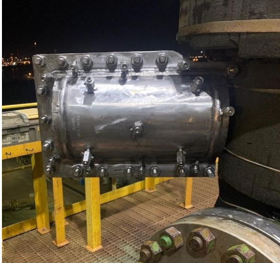
Rajah 1. Pengapit Paip sementara pada injap yang telah bocor
