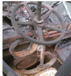
Figura 3 Válvula de bloqueio cego de linha após o incidente
