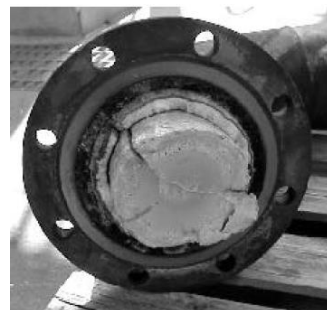
Hình 1: Ống thông hơi bị tắc
