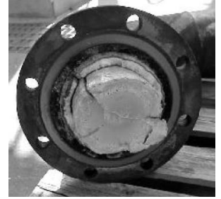
Fig. 1 Tıkalı vent hattı
