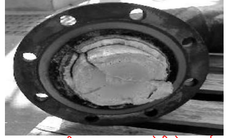
आकृती क्र. १ प्लग झालेली वेन्ट लाईन
