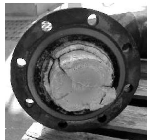
図1 閉塞したベント配管
