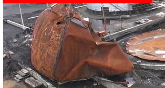
Fig.2 : Tanques de hidrocarbonetos quentes
