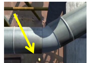
Está líquido a pingar deste tubo isolado?
