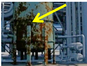
Este tanque parece oxidado e corroído!
