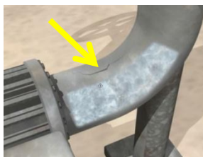
آیا خط لوله ترک خورده است؟
