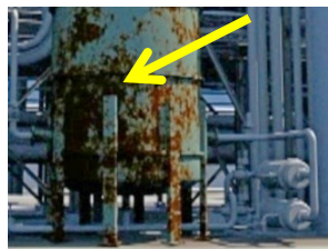
贮罐锈蚀和腐蚀了。
