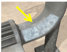
那是管子上的裂缝吗？
