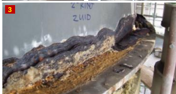
(1) И (2) – Примеры разрушенной изоляции (3) – Коррозия вследствие разрушения изоляции
