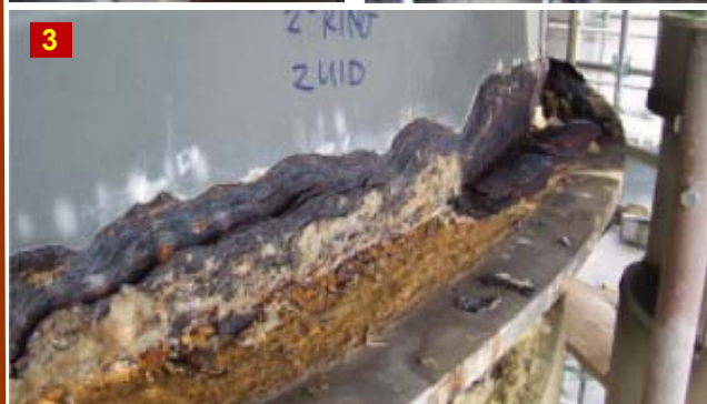
(1) și (2) – Exemple de izolație deteriorată (3) – Coroziune datorată izolației deteriorate
