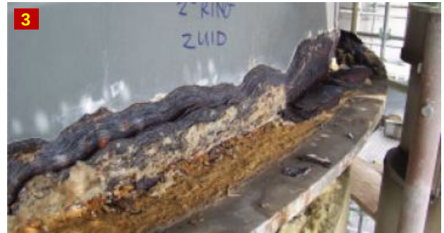
(1) and (2) – क्षतिग्रस्त इन्सुलेशन के उदाहरण (3) – क्षतिग्रस्त इन्सुलेशन के फल स्वरूप संक्षरण
