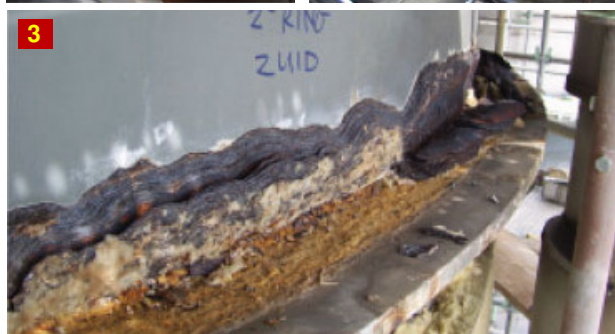
(1) 與 (2) - 保溫層損傷的例子 (3) - 因保溫層損傷而造成的腐蝕
