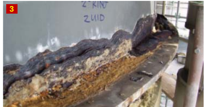
(1) and (2) – Voorbeelde van beskadigde insulasie. (3) – Korrosie as gevolg van beskadigde insulasie.
