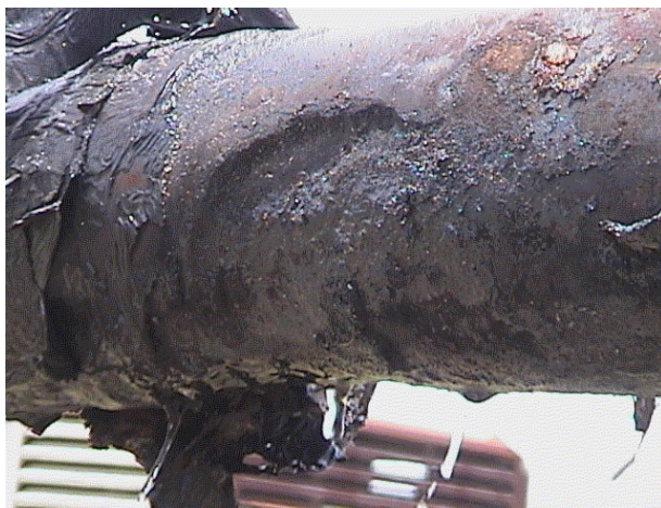
Corrosión de Tuberías
