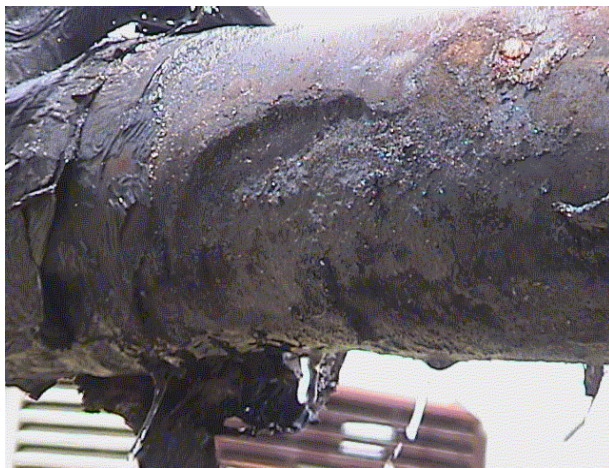
Ataque Corrosivo em tubulação
